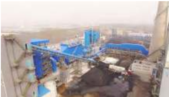
山东兖州聚源热电 58MW 链条炉烟气脱硫脱硝项目
