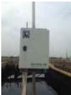
金山污水厂设备
