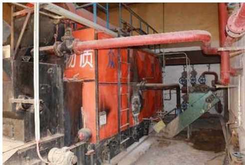
图 1.6.2 调研锅炉房现场
