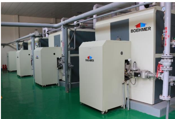
图 1.4.1 调研锅炉房现场
