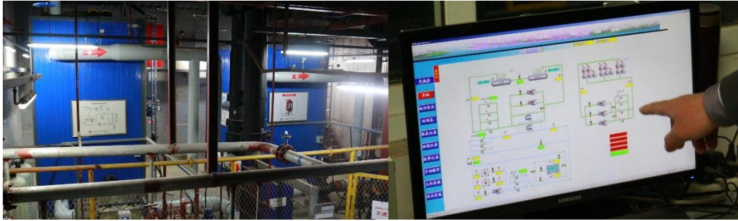
图 1.3.3 调研锅炉房现场
